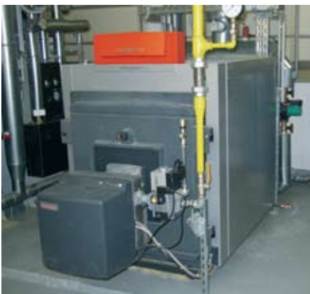
Vitorond 200 installation in Hessischer Hof Hotel, Frankfurt
